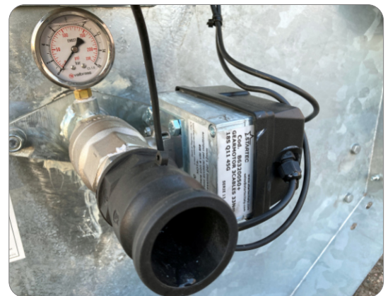
Automatische Abschaltung über elektrisches Ventil
